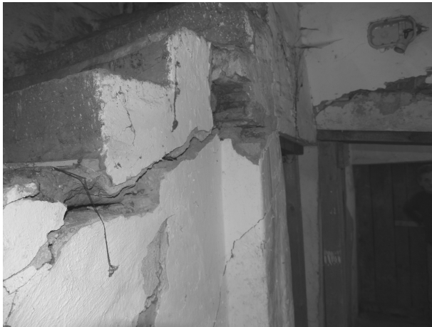
Rys. 10. Uszkodzenia betonowego biegu schodowego.
