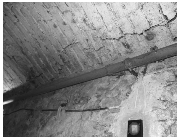
Rys. 8. Spękanie wzdłuż krawędzi wezłowania (c).
