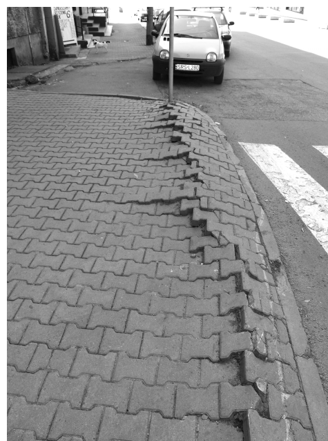
Rys. 4. Deformacja nawierzchni chodnika.
