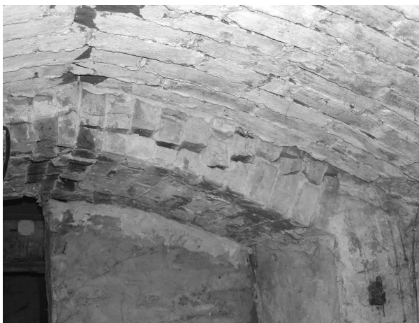
Rys. 7. Spękanie łukowego nadproża.
