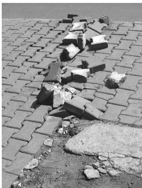
Rys. 3. Deformacja nawierzchni chodnika.
