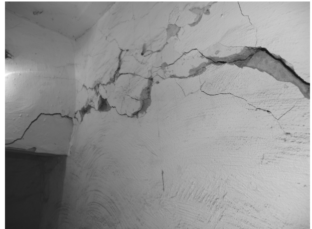
Rys. 11. Spękania w ścianie poprzecznej.
