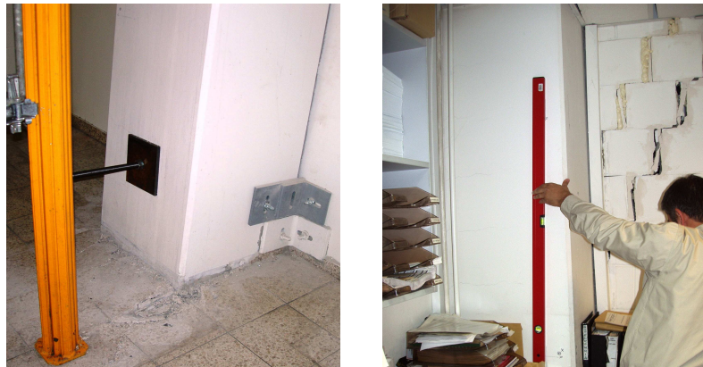
Rys. 6. Widoki przechylonych słupów przy ścianach szczytowych
