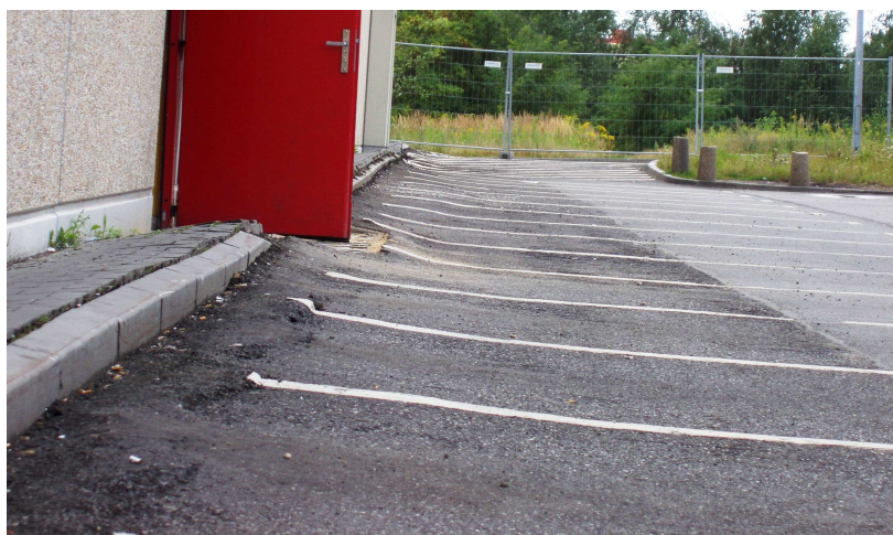
Rys. 4. Deformacje terenu przy ścianie szczytowej w osi „9”
